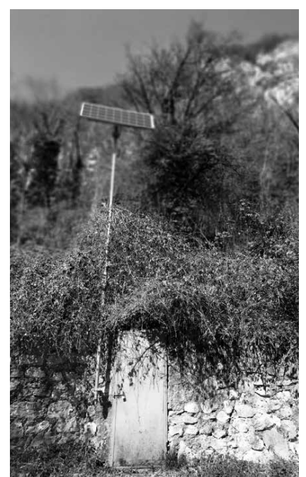
Foto 8) Porta di accesso ad una delle due attuali prese di acquedotto in Cavazzino
