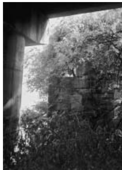
Particolare del ponte in cemento armato e della testa sinistra del vecchio ponte in legno e ferro. (Foto Borgoantico)
